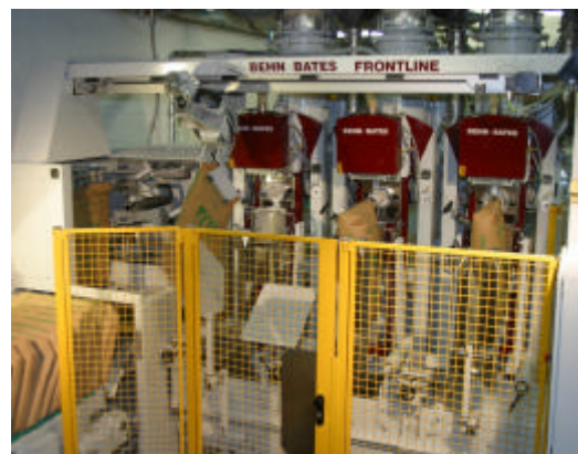
Automatische Abfüllanlage mit FRONTLINE-Ventilsack-Aufsteckautomat, 3 Pneumatikpackern und Ultraschall-Verschleißstationen
